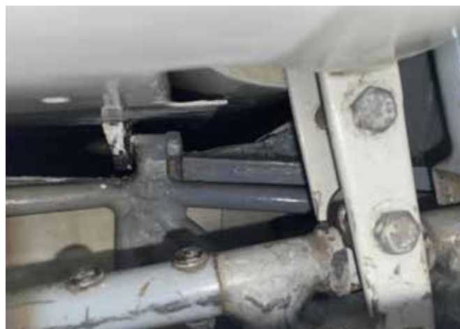
De ploeg die het bewuste toestel monteerde had niets abnormaals gemerkt.
