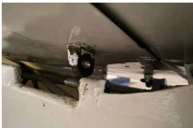
De ploeg die het bewuste toestel monteerde had niets abnormaals gemerkt.
